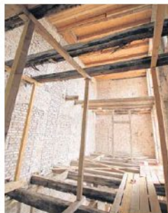
An einigen Balken sind die Schäden noch zu sehen.
