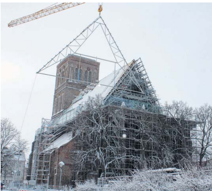
2010: Die neuen Traggerüste für das Kirchendach werden montiert. Im Februar 2012 hieß es dann: Das 2,1 Millionen Euro teure Dach ist endlich dicht.
