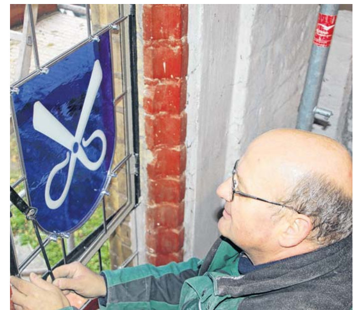
Es ist vollbracht: Wilfried Westphal setzt am Donnerstag das letzte Fenster in der Sakristei ein - damit ist die Aktion „Fenster dicht“ abgeschlossen.
