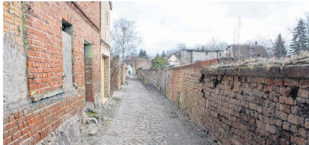
An den Resten der Anklamer Stadtmauer lassen sich überraschende geschichtliche Entwicklungen von der Stadtgründung bis heute ablesen. Doch sie zeigen auch, dass dringend etwas zum Erhalt des historischen Denkmals getan werden muss.
