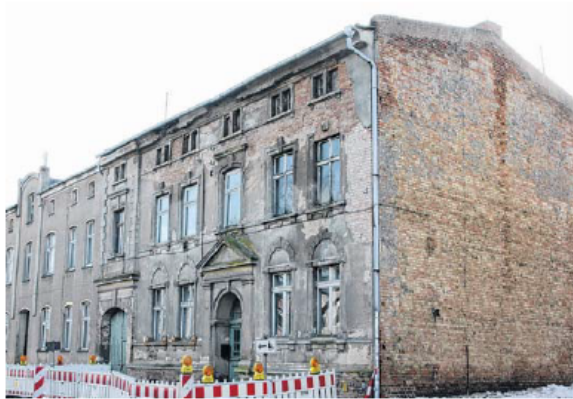
Am Sonntagabend musste die Feuerwehr ausrücken, um dieses denkmalgeschützte Haus zu sichern. Lose Stücke des Fassadenputzes waren auf den Gehweg gestürzt. FOTO: VERONIKA MÜLLER
