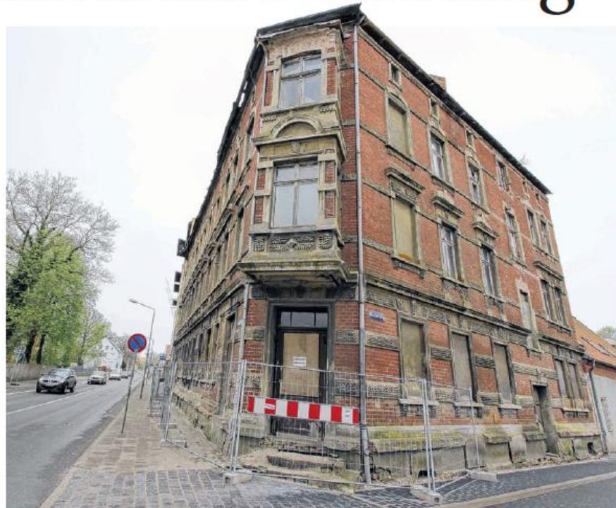
Seit gut anderthalb Jahren wurde an dem Haus nicht gearbeitet. Der Zustand des Gebäudes wird immer schlechter - obwohl es zu den schönsten noch erhaltenen Altbauten im Stadtgebiet zählen könnte.
