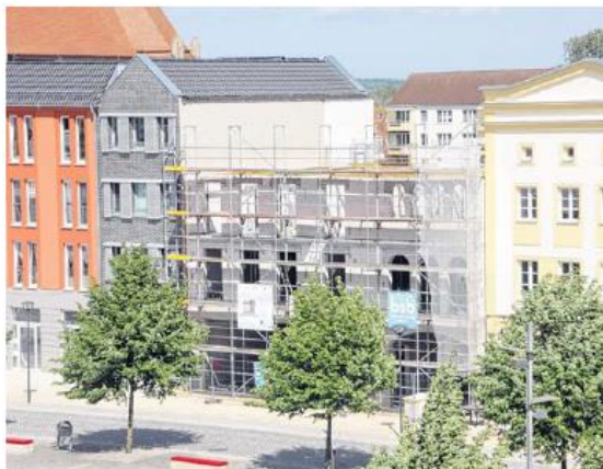
Der Rohbau ist fast fertig, wenn alles so gut weiterläuft, können im Frühjahr die Möbelwagen anrollen. FOTO: VERONIKA MÜLLER
